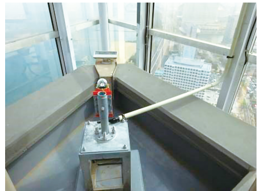
写真4 低光度航空障害灯
